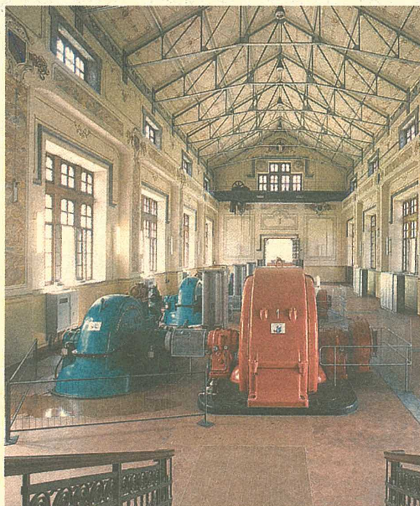
Villeneuve (Ao). L'interno della centrale Champagne 1
